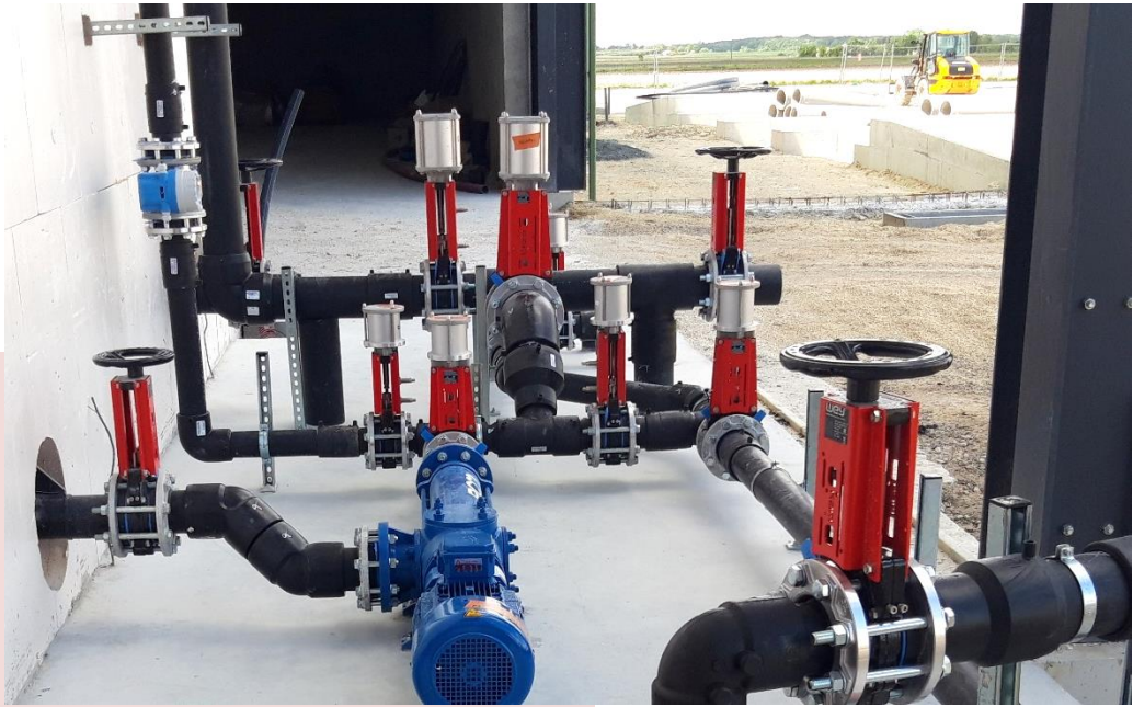
Anneau de distribution du digestat liquide
