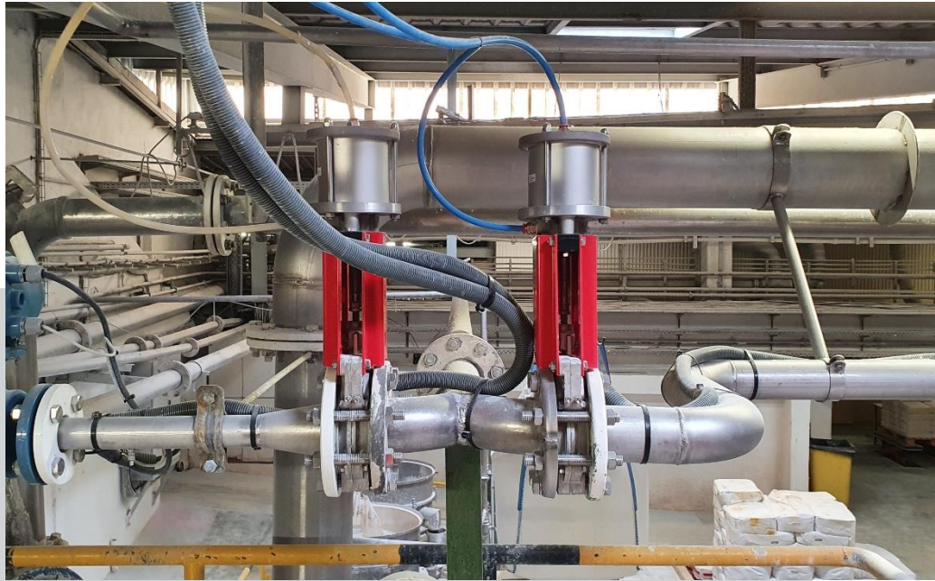
Wey Plattenschieber VN in der Dosierungsanlage für Calciumcarbonat
